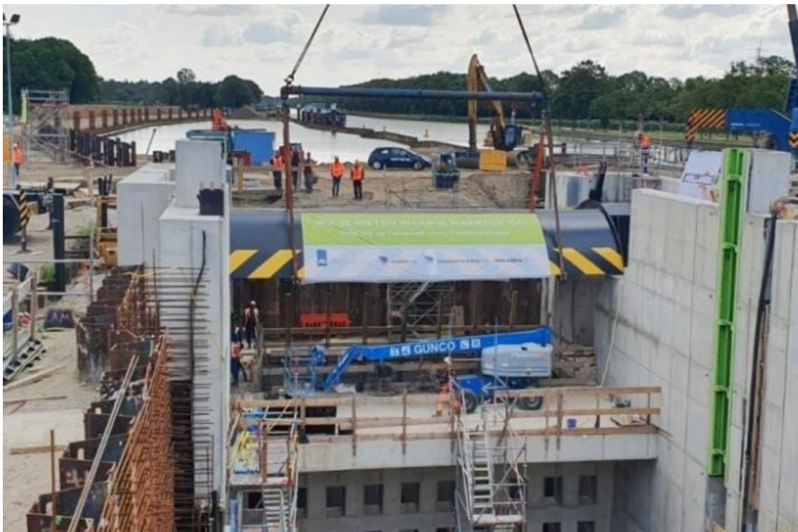
Figuur 8-2: Plaatsing van de segmentdeur in het bovenhoofd van de nieuwe kolk in het sluiscomplex Eefde tussen het Twentekanaal en de IJssel, in gebruik sinds 2020.
