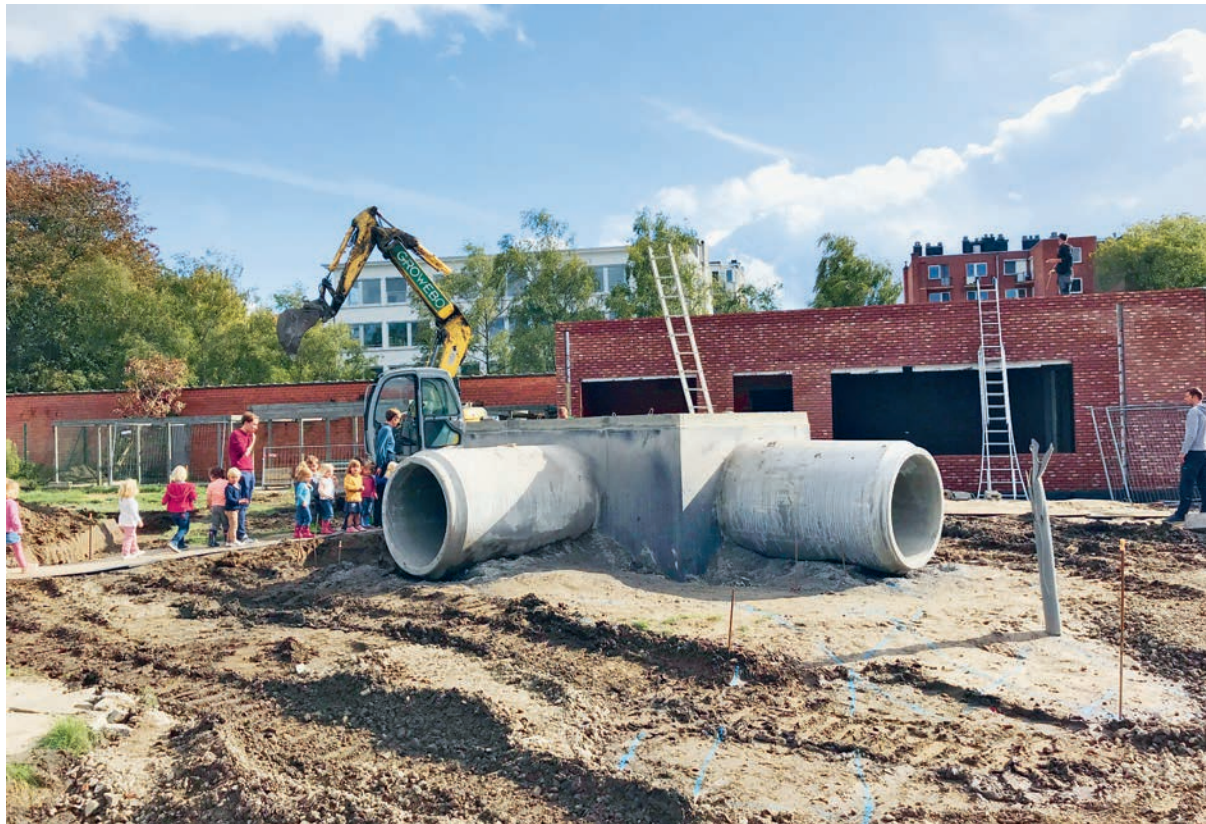
Het ontwerpteam betreft de leerlingen actief bij de heraanleg van hun nieuwe speelplaats, ook tijdens de werffase. © Cedric Ryckaert, Klimaat-speelplaats Sint-Paulus
