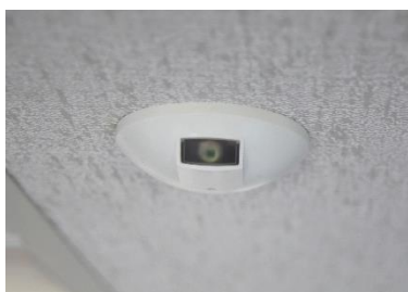
Figuur 91: Daglichtsensor aan het plafond
