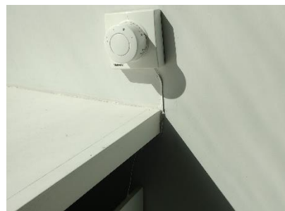
Figuur 60: Voorbeeld van een verplaatste thermostaatkraan
