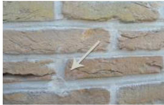
Figuur 101: Zicht op de geboorde gaten in het buitenmetselwerk
