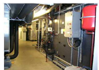
3 Ventilatielokaal Local de ventilation
