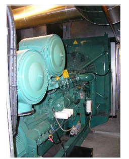
1 Diesel stroomgenerator Groupe électrogène diesel
