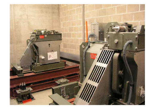
① Machinekamer lift Local machine d'ascenseur
