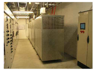
5 LS-lokaal + transformatoren 11 kVA Local BT + transformateurs 11 kVA
