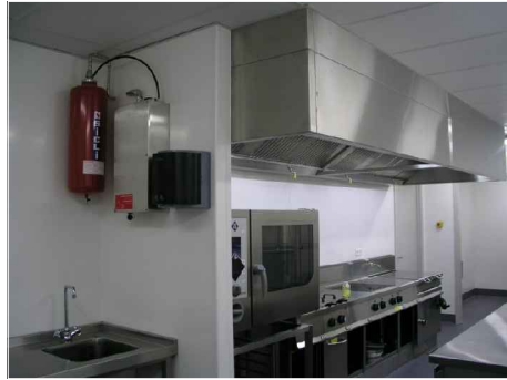
① Automatische blusinstallatie (Sillautex AFFF 6%) Système automatique d'extinction (Sillautex AFFF 6%)
