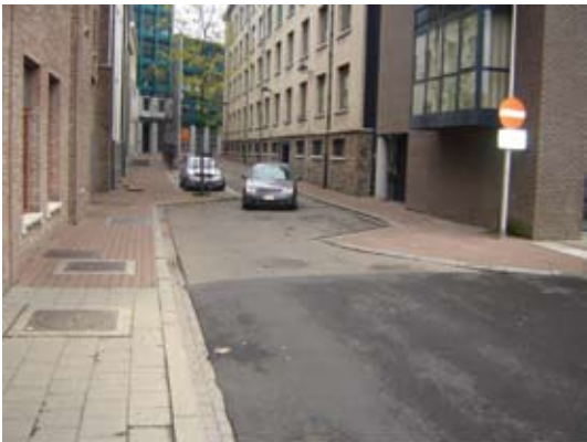
Fig. 2.2.2c Versmalling van de rijbaan.
