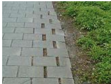
Fig. 2.1.3k De graskant langs een verharding kan dienen als een natuurlijke geleider. Zorg ook voor een goed onderhoud van de verharding. Met degelijke kantopsluiting en een gepaste fundering kunnen problemen zoals op de foto voorkomen worden.
