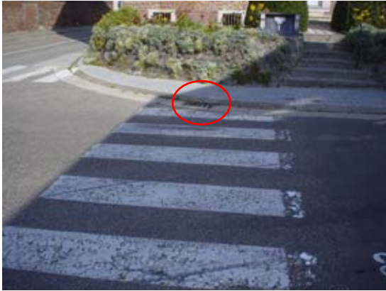
Fig 2.1.4g Op plaatsen waar de logische looproute de rijbaan kruist mogen geen straatkolken voorkomen. Wanneer de openingen het rooster >2cm zijn, bestaat het gevaar dat kleine wielen er in komen vast te zitten. Ook voor dames met hoge hakken kunnen roosters een probleem vormen.
