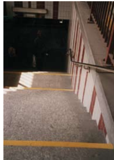
Fig. 2.1.4x Trap met ononderbroken contrasterende strips op de eerste en op de laatste trede. Vanaf deze positie is niet te zien of ook de eerste en de laatste trede op het verticale gedeelte van de trede zijn gemarkeerd, dat zou ideaal zijn.
