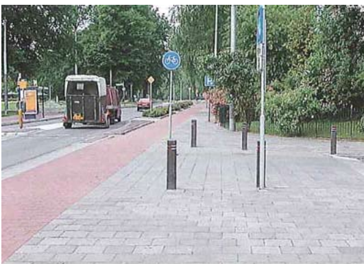
Fig. 2.2.2e Een uitritconstructie (doorlopend trottoir), waarbij men verzuimd heeft de geleidelijn voor blinde en slechtziende personen te voorzien. Voetgangers met een visuele beperking lopen hier het risico gedesoriënteerd te raken.
