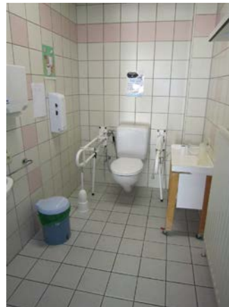
Toilet met opklapbare beugels met extra steunpoot als beveiliging tegen afbreken door neerploffen en een werkblad voor het plaatsen van verzorgingspullen.
