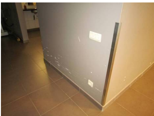
Beschadiging aan hoeken. Stijn vzw, © Enter vzw
