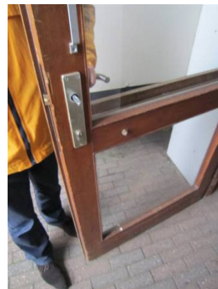
De klink aan de binnenzijde van de deur wordt verwijderd als beveiliging (noodoplossing).
