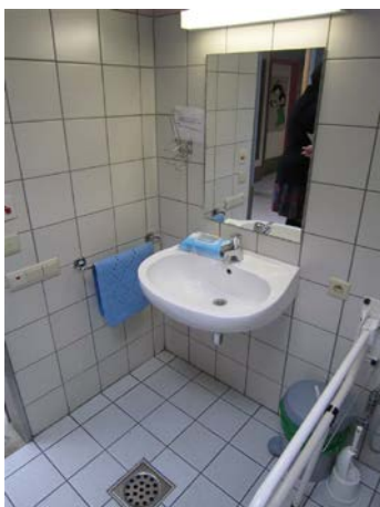
Voldoende grote wastafel aan een toilet. St. Lodewijk vzw, © Enter vzw
