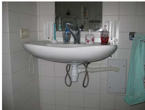
Wastafel gemonteerd op een in hoogte verstelbaar systeem en uitgevoerd met een flexibele afvoer. Ado Icarus, © Toegankelijkheidsbureau
