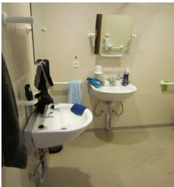
Wastafel gemonteerd op een in hoogte verstelbaar systeem en uitgevoerd met een flexibele afvoer. Revalidatiecentrum UZ Gent, © Enter vzw
