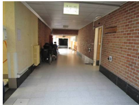
Verhoogde plint aan de muren. Hoeken met hoekprofielen in kunststof. Dominiek Savio Instituut, © Enter vzw
