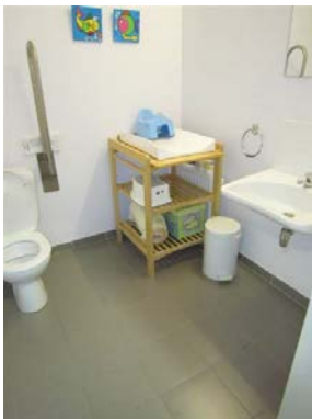
Aangepast toilet met een verzorgingstafel. Let wel, de verzorgingstafel verspert de transferruimte. KiDs vzw vzw, © Enter vzw
