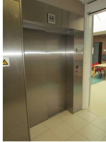
Lift met brede toegang. Omdat ze niet zo goed zichtbaar (herkenbaar) is, werd een extra pictogram bovenaan toegevoegd. Zorgcentrum Maria - Ter - Engelen vzw, © Enter vzw
