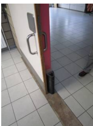
Bescherming van de deur: kunststof hoekbeschermer voor het loshangende deel. St. Lodewijk vzw, © Enter vzw
