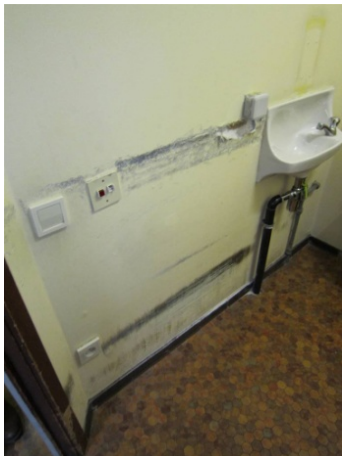
Beschadiging (op 2 hoogten) van de wand naastliggend aan de deur door elektrisch rolstoelgebruik (de ruimte is te klein om te manoeuvreren).
