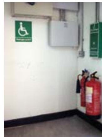
✓ Brandblusapparaat aangebracht op de juiste hoogte
