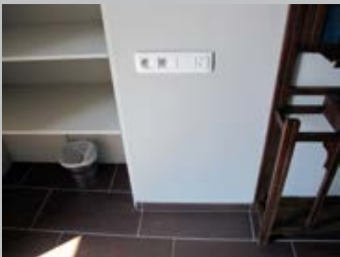
✔ Stopcontacten en schakelaars naast elkaar aangebracht op dezelfde hoogte
