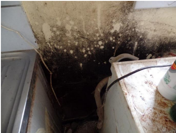
opstijgend vocht met erge schimmelvorming
