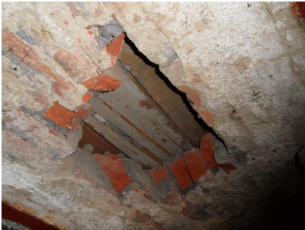
deel van welfselvloer boven kelder ontbreekt
