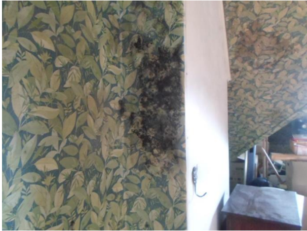
condensatie op een wandje onder dak
