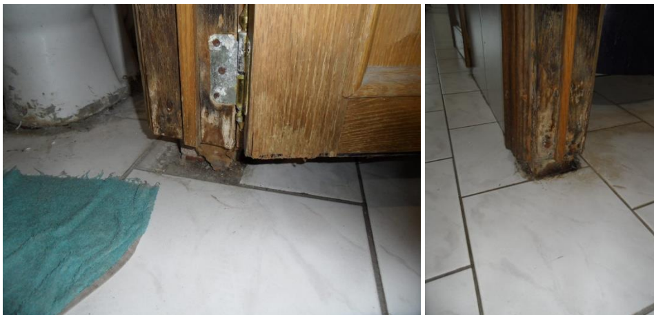
opstijgend vocht in houten deurkader
