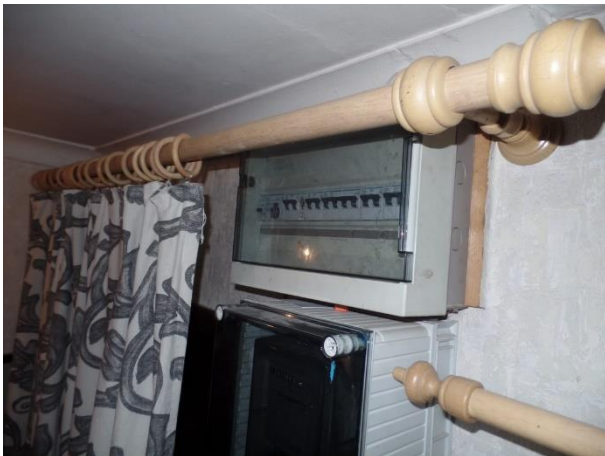
Zekeringkast moeilijk bereikbaar
