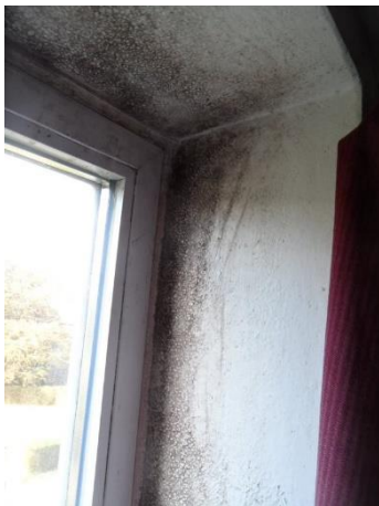
condensatie met schimmelvorming
