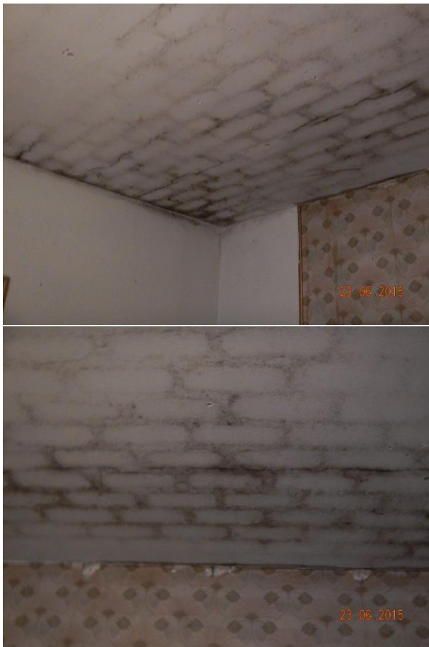
condensatie met schimmelvorming aan plafond
