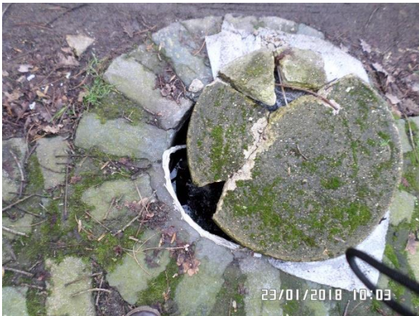
Beschadigd deksel regenput naast terras.
