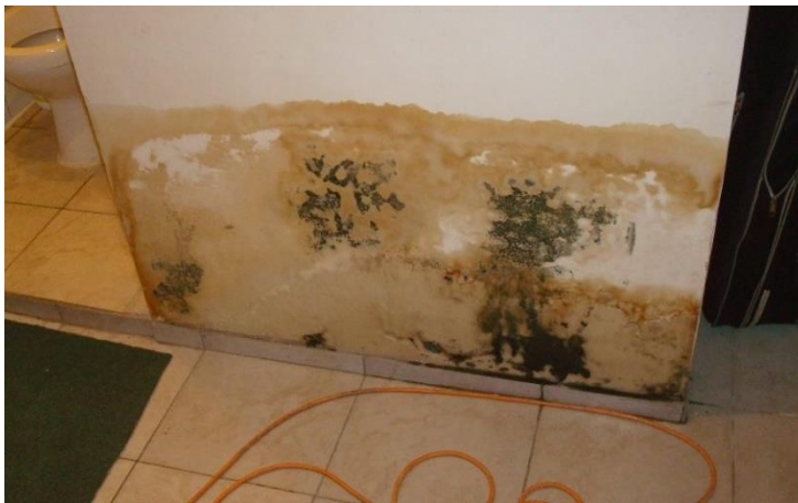
opstijgend vocht met schimmelvorming
