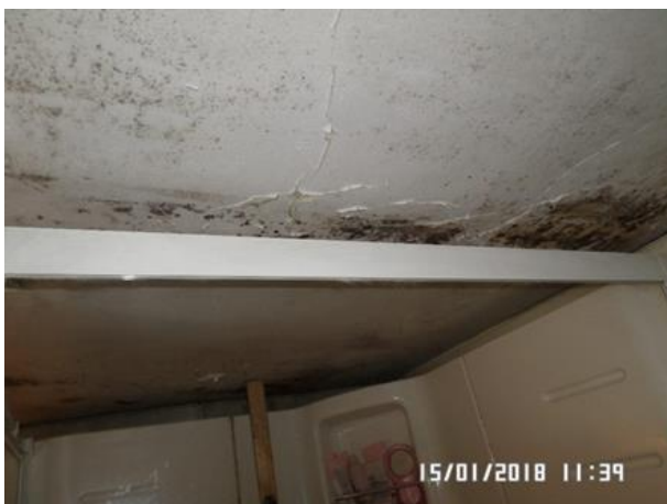
condens en schimmelvorming plafond badkamer
