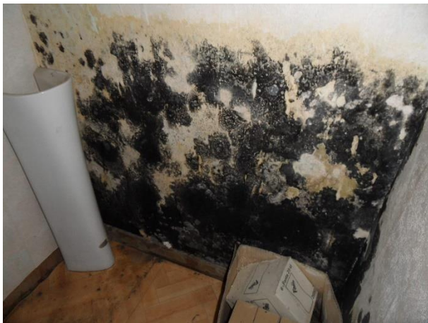
opstijgend vocht met schimmelvorming
