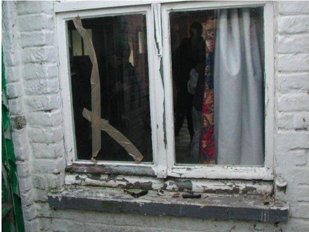
Dubbele beglazing ontbreekt in een woonlokaal
