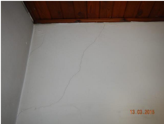
barsten in bovenhoek binnenmuur
