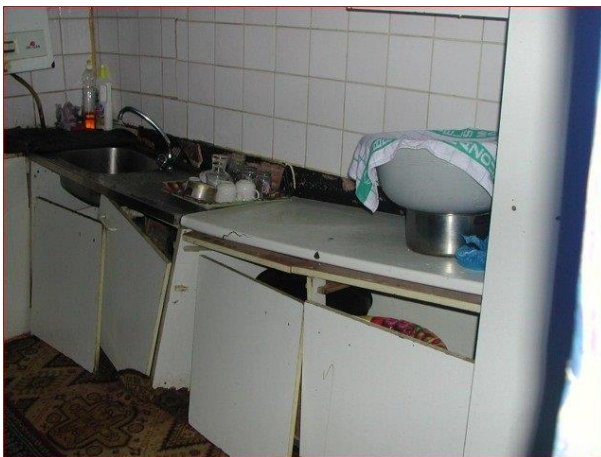
gootsteen verzakt – niet aanwezig
