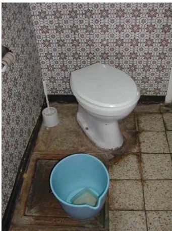
toilet niet aangesloten op watertoevoer
