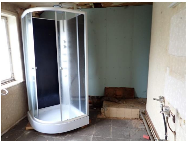
douche niet aangesloten (niet aanwezig)
