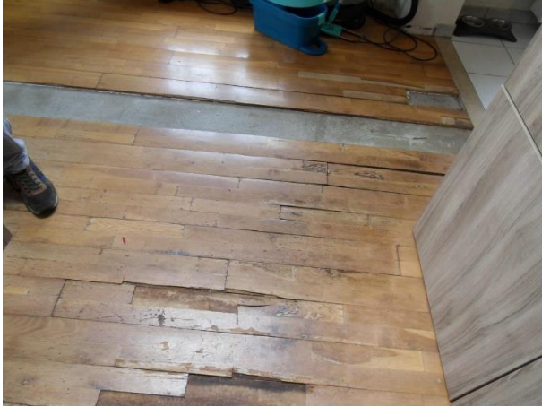
gevolg van vochtschade aan parketvloer
