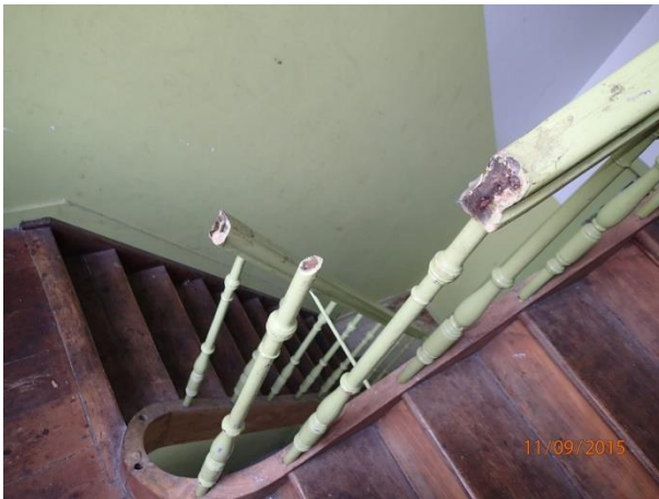
twee ontbrekende spijlen aan het bordes
