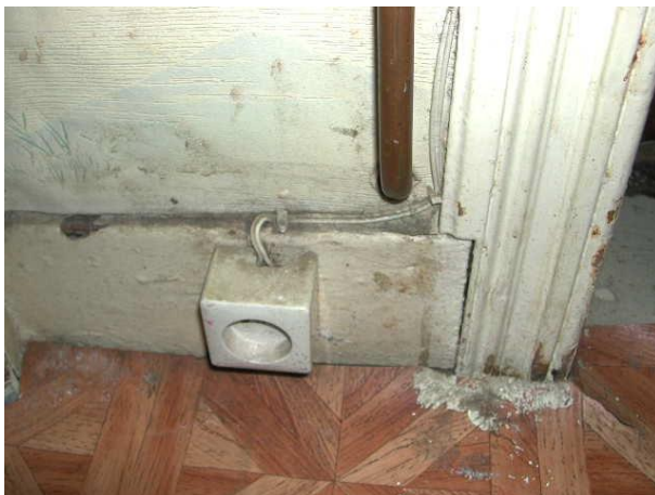
stopcontact ontbreekt in de slaapkamer
