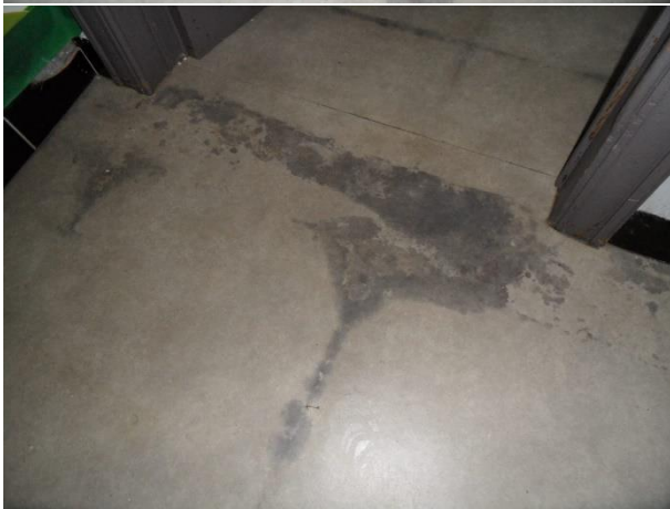
vochtschade aan linoleumvloer
