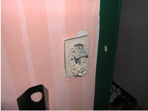
stopcontact ontbreekt in de leefkamer
