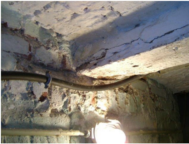
aantasting houten balk door houtrot
