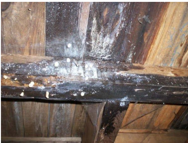
houten draagvloer aangetast door schimmel
