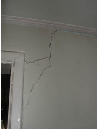
barst en beschadiging tussen opleg en dragende binnenmuur
