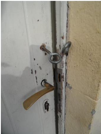
woning niet slotvast afsluitbaar
