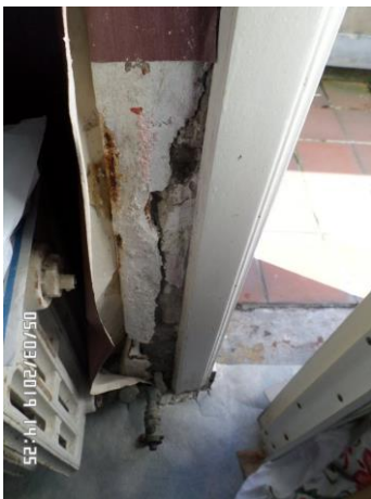
opstijgend vocht in buitenmuren
