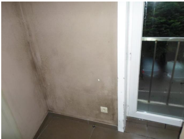
condensatie met schimmelvorming
