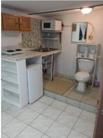
Toilet niet afgescheiden van keuken en leefruimte
