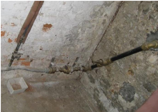
opstelling watermeters in een meergezinswoning
