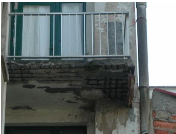
terrassen met ernstig betonrot
