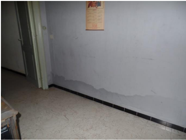
opstijgend vocht over een volledige muur
