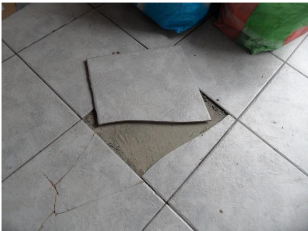
losgekomen en gebarsten vloertegels
