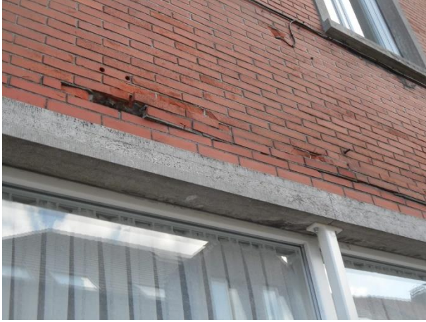
loszittende stenen en voegwerk
