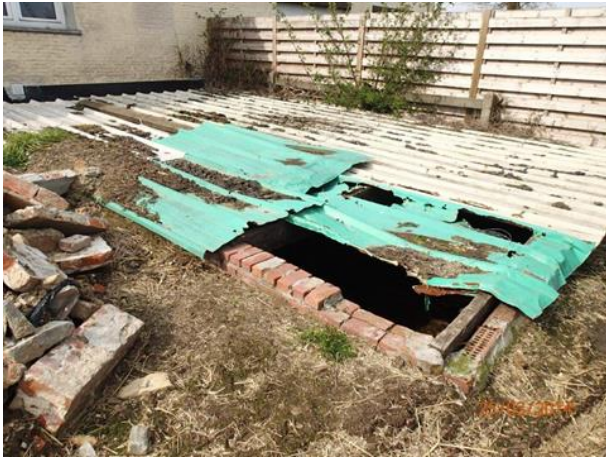
Onvakkundig afgedekte beerput in tuin.
