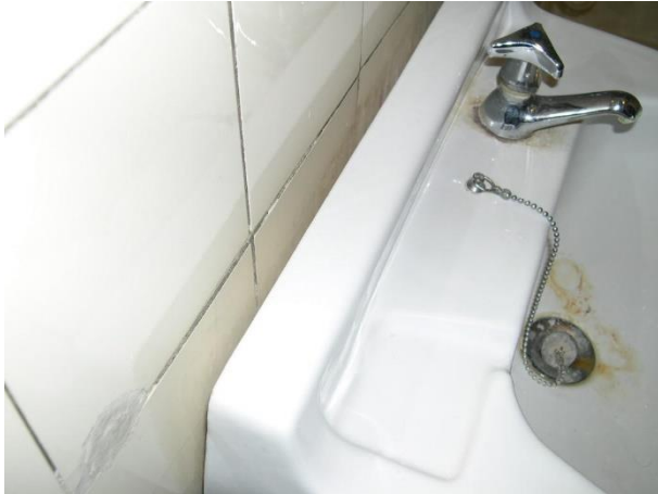
lavabo hangt los van de muur
