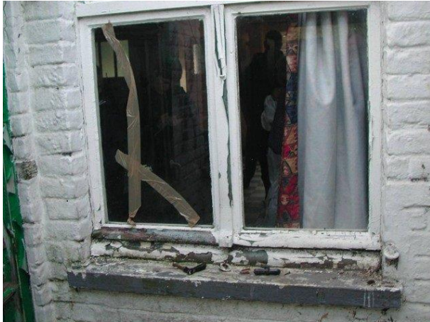
Dubbele beglazing ontbreekt in een woonlokaal
