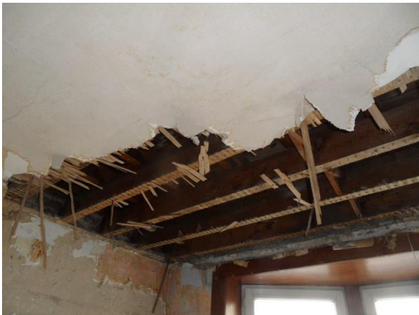
plafondafwerking grotendeels afwezig
