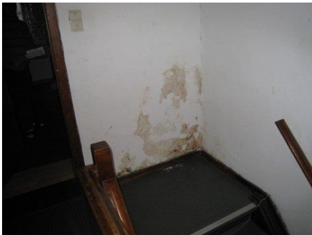
opstijgend vocht in binnenmuur
