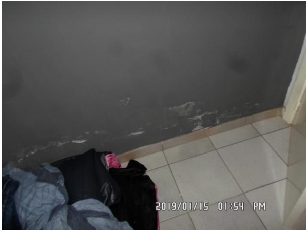
opstijgend vocht in buitenmuren
