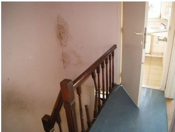
vocht met schimmelvorming op binnenmuur
