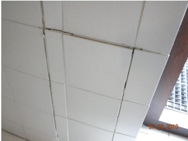
afwerking wandbetegeling beschadigd
