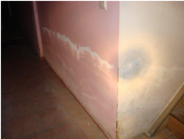
schade door opstijgend vocht
