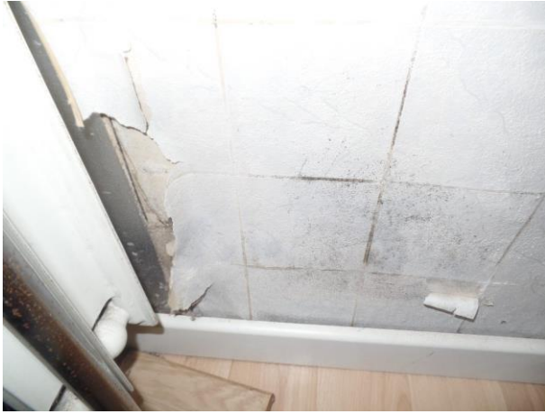
opstijgend vocht in binnenmuur
