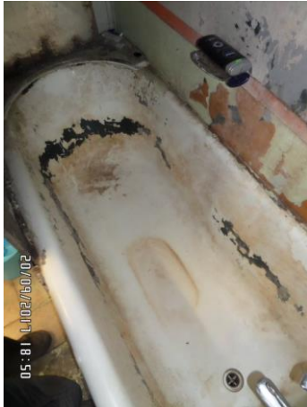
bad ernstig beschadigd
