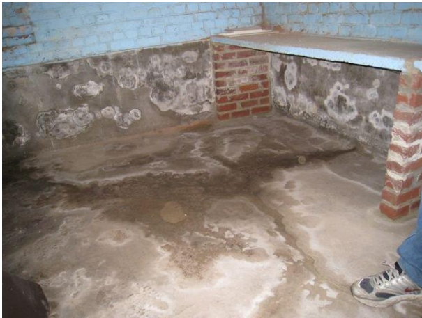
lichte vochtschade op kelderwanden en -vloer
