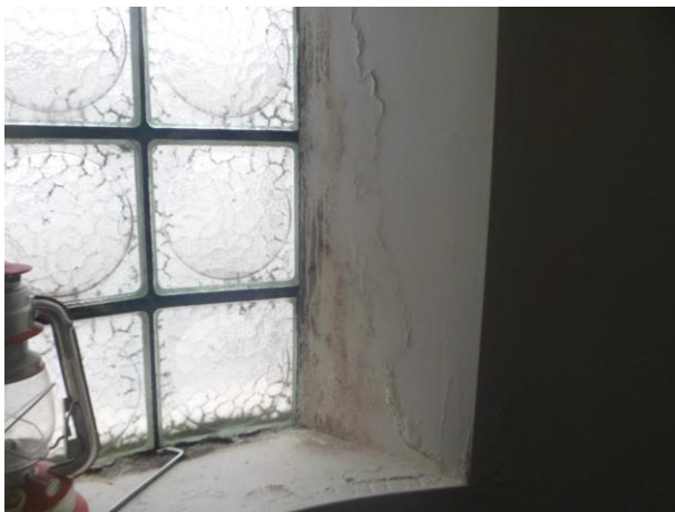
condens en schimmelvorming in een raamneg
