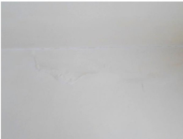
opgedroogde vochtschade bovenaan buitenmuur in gemeenschappelijke inkomhal
