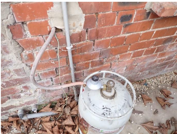
verweerde slang, foutief aangesloten
