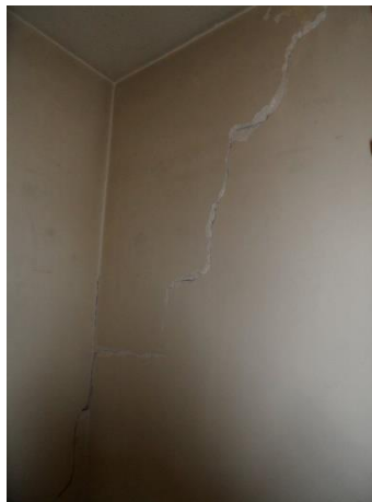
scheurvorming dragende binnenmuren
