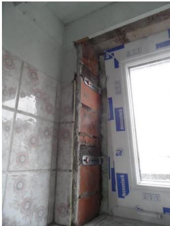
afwerking rond raam ontbreekt
