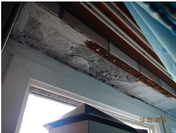
afwerking raamomranding ontbreekt
