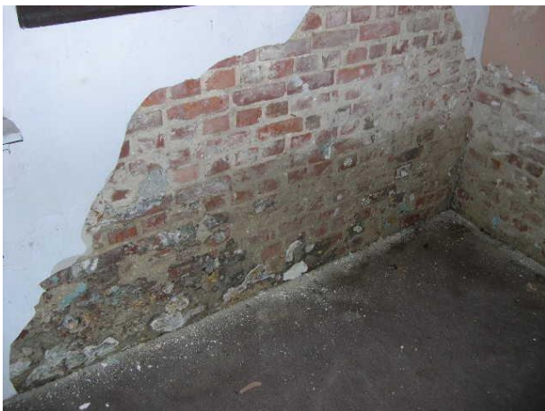
schade door opstijgend vocht
