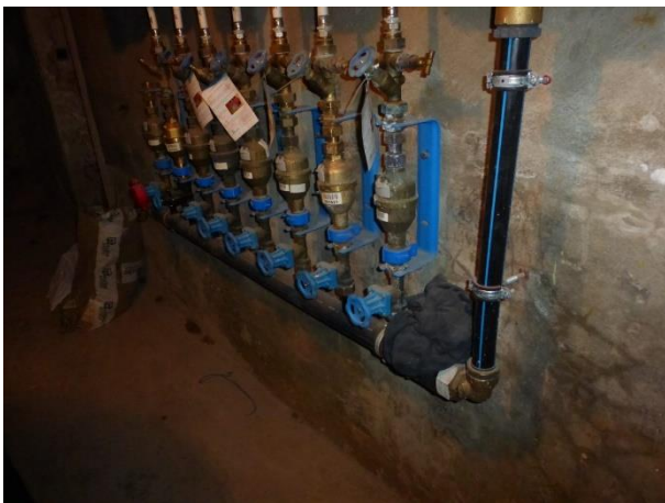
opstelling watermeters in een meergezinswoning
