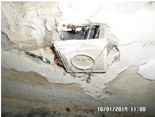
opstijgend vocht in binnenmuur
