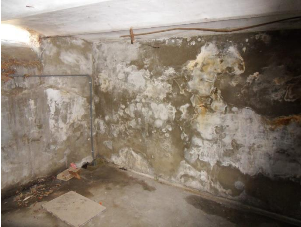
vochtige muren en plasvorming
