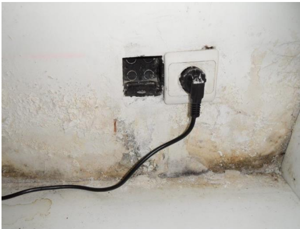
Stopcontact in vochtige muur
