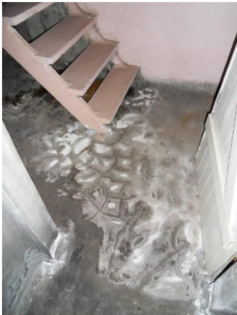
zoutvorming op keldervloer
