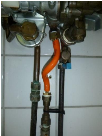
foutieve aansluitleiding en aansluitwijze gebruikt
