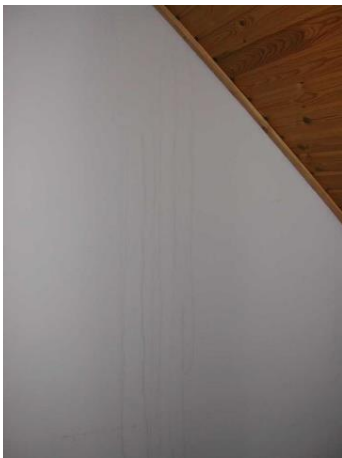
insijpelend vocht via het dak
