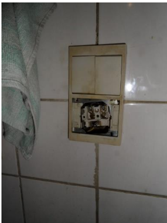
centraalplaat stopcontact ontbreekt; delen onder spanning aanraakbaar
