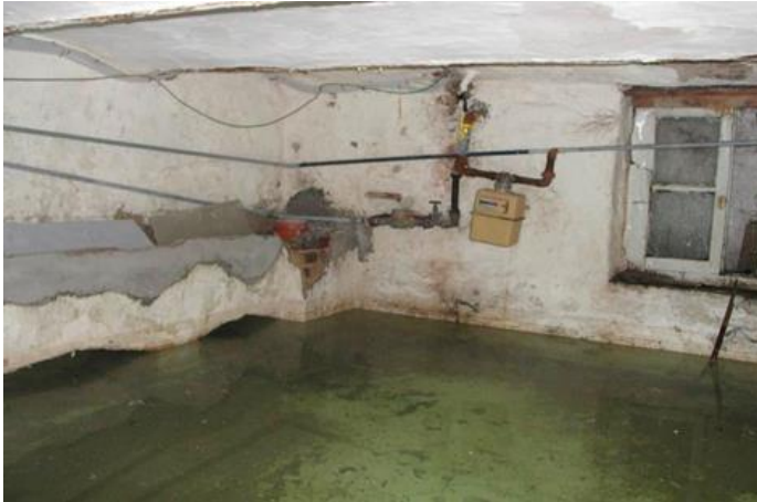
Watermeter (en gasmeter) niet afsluitbaar
