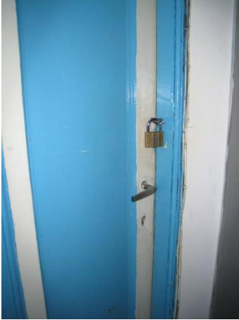
woning niet slotvast afsluitbaar
