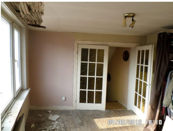
pleisterwerk plafond beschadigd
