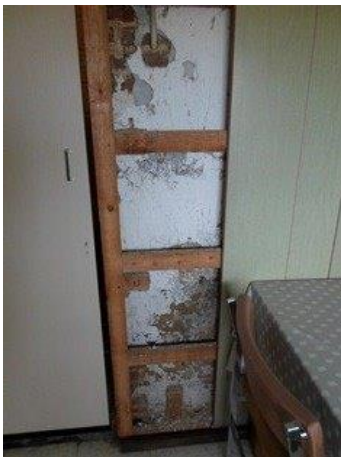
opstijgend vocht met schimmelvorming achter voorzetwand
