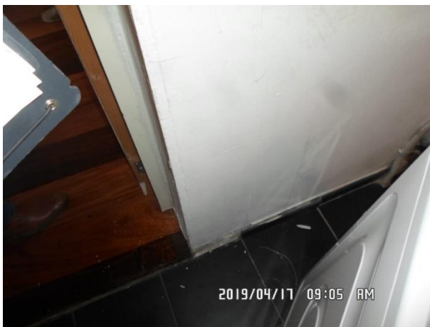
opstijgend vocht op binnenmuur
