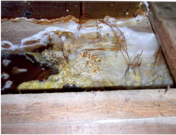
huiszwam aan kelderplafond
