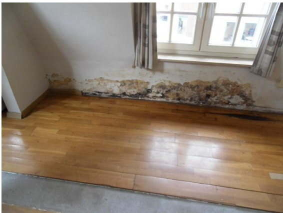
doorslaand vocht op verdieping
