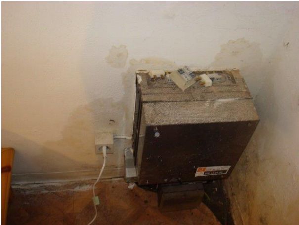
opstijgend vocht in binnenmuur
