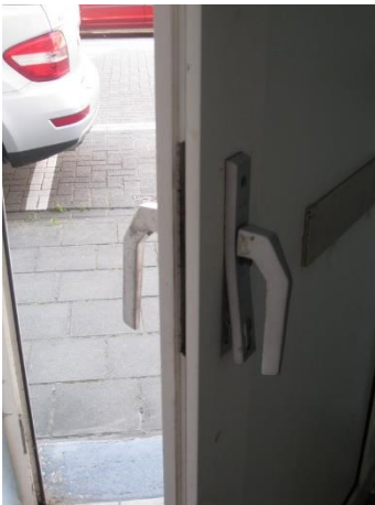
woning niet slotvast afsluitbaar
