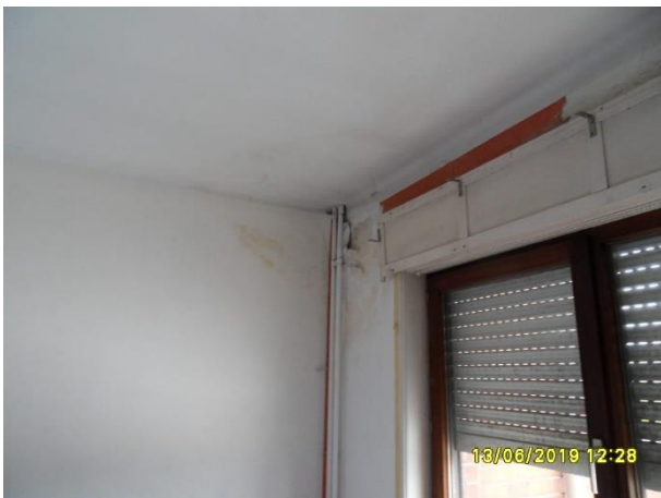
opgedroogde vochtschade aan plafond
