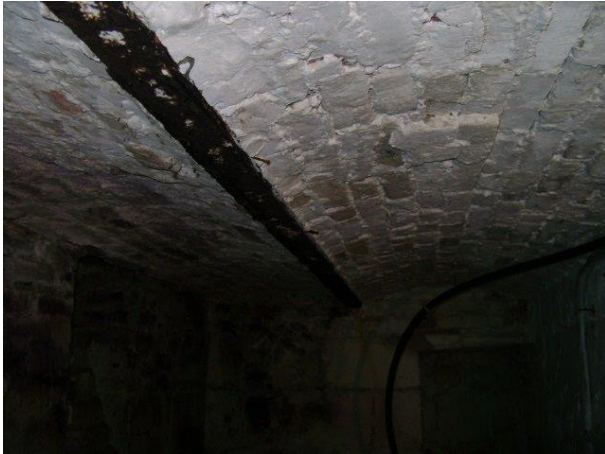
sterke roestvorming op draagprofiel kelderwelfsel
