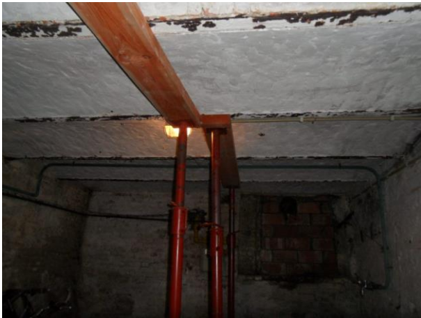
onvakkundig stutwerk van een kelderplafond
