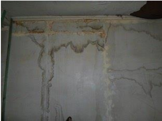
vochtschade op gemeenschappelijke muur
