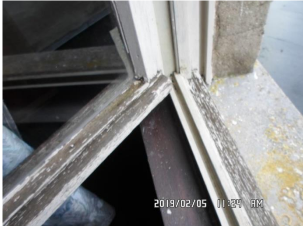
raam met verweerd schilderwerk
