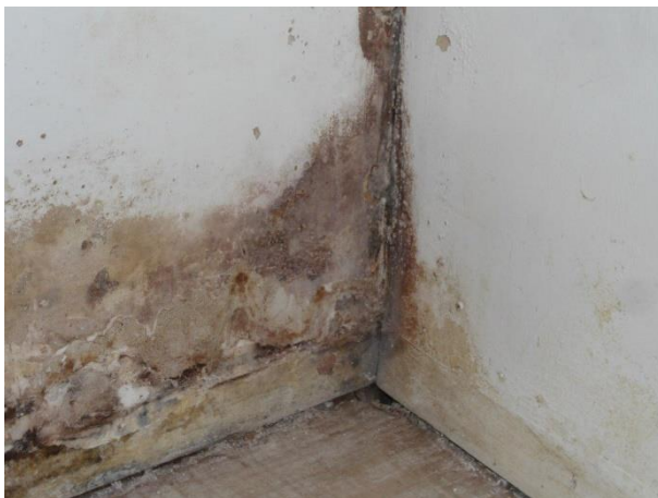
opstijgend vocht met schimmelvorming
