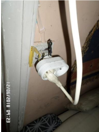
stopcontact zonder afscherming – niet conform en dus onbestaand
