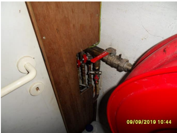
watermeter niet bereikbaar
