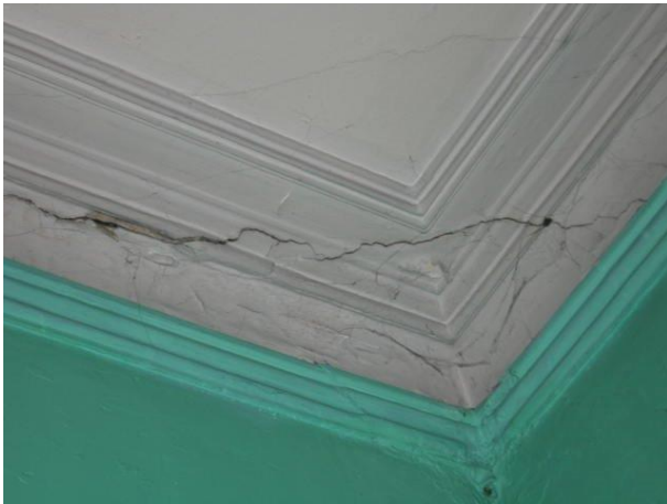
barst in een hoek van een plafond in stucwerk
