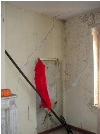
afscheuring van een deel van een binnenmuur, doorgaand in plafond
