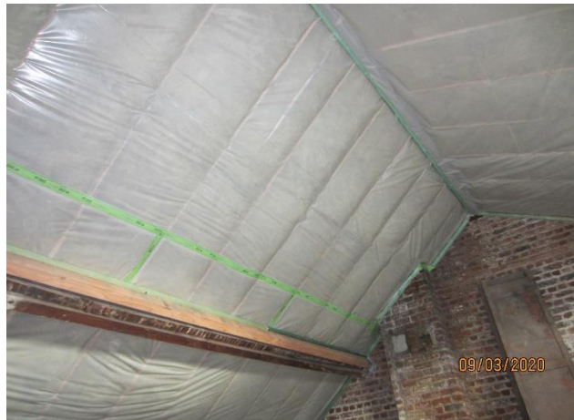
Figuur 9: regelmatige onderbreking van de halfstijve isolatie door de dakkepers
