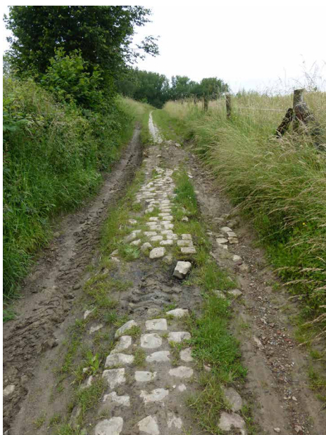
FIG 132 Schade aan kasseistrook door landbouwverkeer in een holle weg in Asse (foto: Inge Verdurmen).
