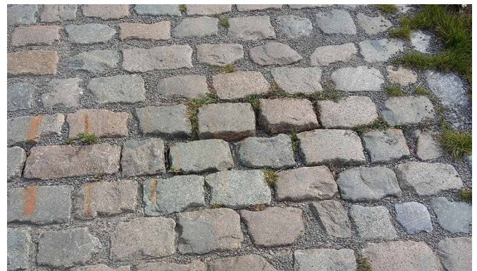
FIG 150 Ontbrekende voegvulling in de kasseiweg Lookhuisstraat in Ichtegem door slechte aanleg (foto: Koert David).
