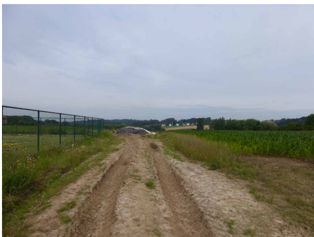
FIG 134 Spoorvorming door zwaar landbouwverkeer in een zandweg naar de Waerborremolen in Asse (foto: Inge Verdurmen).
