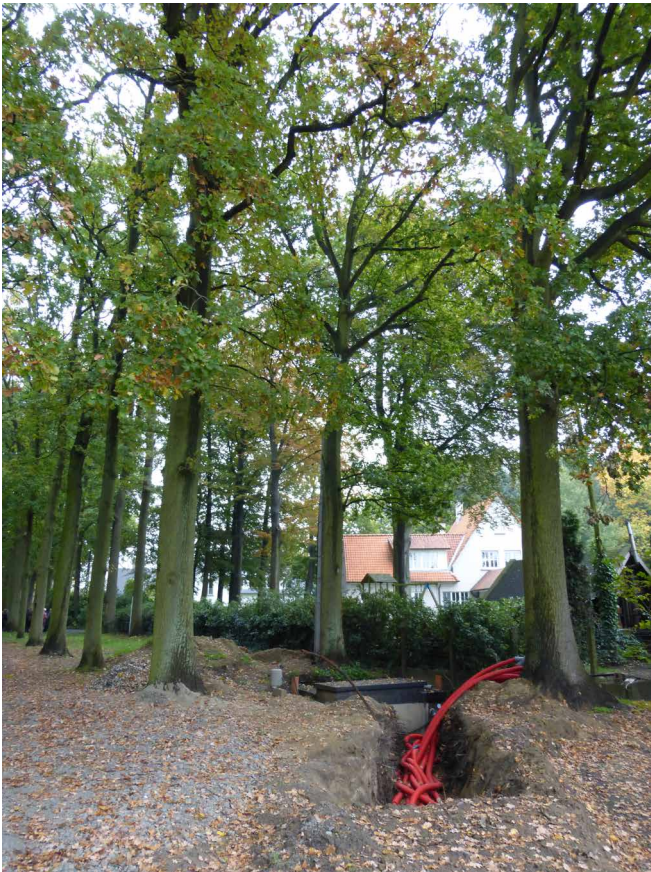
FIG 161 Rioleringswerken met ernstige impact op de dreefbomen in de Overhammedreef in Aalst (foto: Koen Smets).
