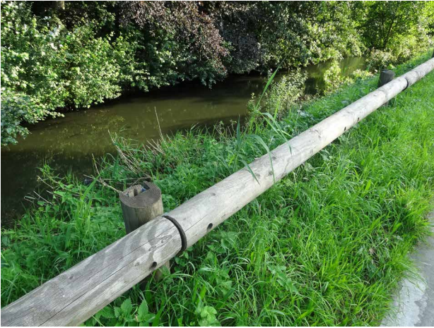
FIG 101 Houten vangrails langs het kanaal Ieper-Komen verhinderen betreding van de onverharde berm (foto: Koen Himpe).
