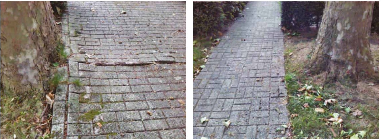
FIG 174A-174B Opdrukkende wortels van platanen onder het voetpad langs de Ridder Berthoutlaan in Niel (Bron: Beheerpan 2016) 87 .
