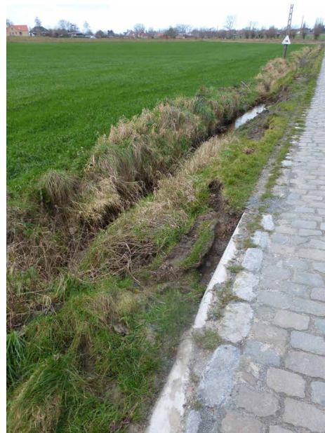
FIG 112 Wateroverlast veroorzaakt uitspoelen van defundering van de kasseiweg Lookhuisstraat in Ichtegem (foto: Inge Verdurmen).
