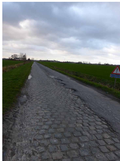
FIG 122 Asfaltstrook ter vervanging van de onverharde weg naast de kasseiweg Vladslostraat in Diksmuide (foto: Inge Verdurmen).
