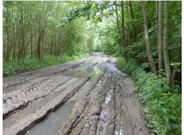
FIG 114 Spoorvorming en stagnerend regenwater op een onverharde bosweg langs de IJzenbeek in Asse (foto: Inge Verdurmen).
